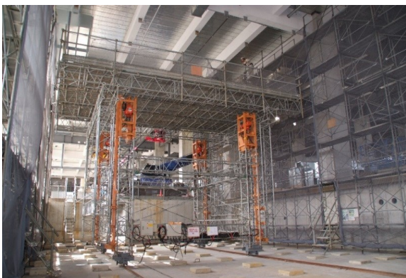
東京国際空港原動機センター 規模：10m x 6m H=7~10m 《移動昇降式足場》 概要：作業床は作業内容で3m範囲で高さ調節可能 床面の機械装置(50cmx50cm)の乱立を縫いレール敷設 作業目的：天井面のダクト・天井走行レールの取付作業
