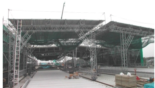
常磐新線守谷駅 規模：22m x 12.3m H=6m 移動距離 120m 概要：屋根鉄骨(球体のトラス)を勾配ステージで受ける 鉄骨荷重を受けるために柱6本・3本レールで走行 使用目的：支保工、天仕上 組立・解体はレッカー使用
