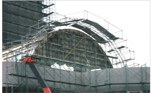
茨城県那珂町庁舎 規模：半径8m 巾8m 概要：かまぼこ型の屋根にヒンジ金物と調整ジャッキを使用 R形状の移動足場を組み施工 作業目的：屋根・仕上
